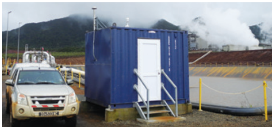
Station des Utilités
