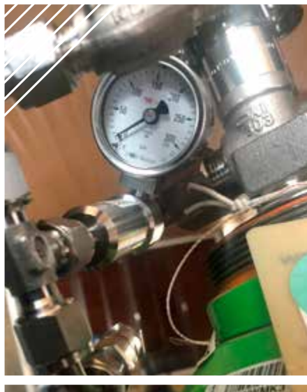
Équipement de contrôle de l'étalonnage des appareils de mesure.
